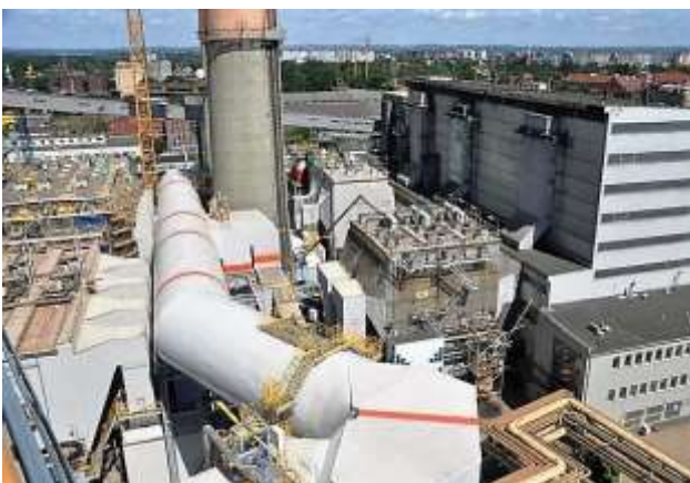
Rys. 4. Instalacja oczyszczania spalin bloku Elektrociepłowni Wrocław. [11]
